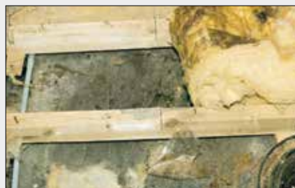
Fukt från mark har trängt igenom betongen/ plastfolien och orsakat mögeltillväxt.
